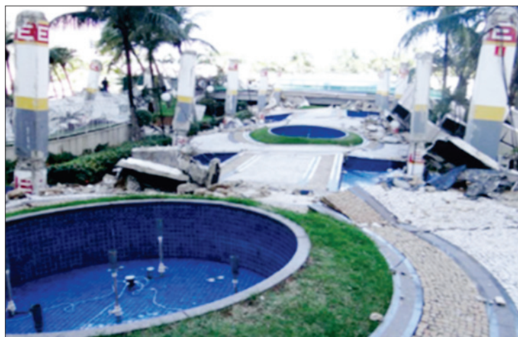
Visão geral da estrutura após o colapso
