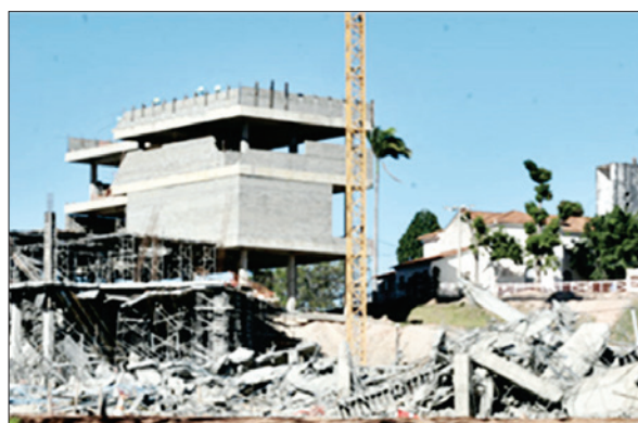
Visão geral da estrutura após o colapso
